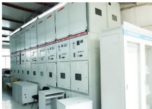
高低压供配电实训室
