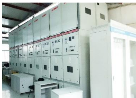
高低压供配电实训室
